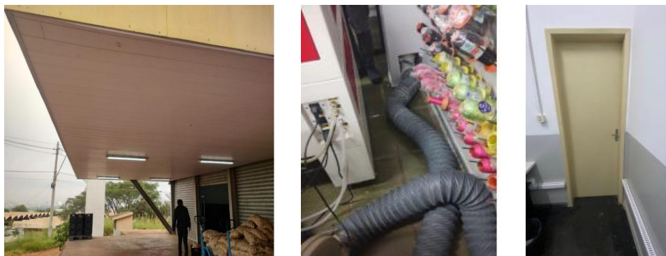
Instalação de forro na CEASA e Instalação de Sistema de Exaustão e Porta na GBS
