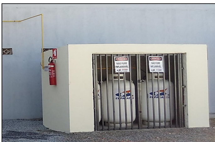
Central de gás GLP
