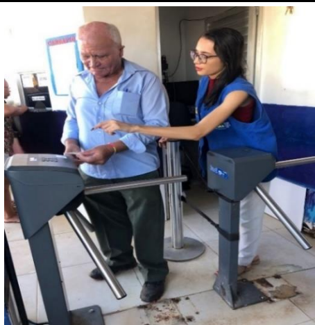
Instalação de catraca na unidade de Luziânia (Jardim Ingá)
